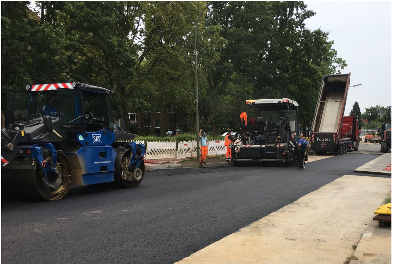
Asphaltierungsarbeiten im Hainholzer Damm in der vergangenen Woche – von außen unsichtbar verläuft die neue Abwasserleitung mehrere Meter tief unterhalb der Fahrbahn. (Foto: AZV Südholstein)
